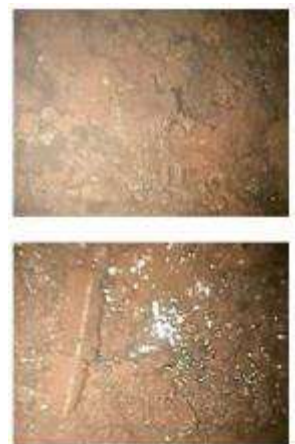
図 2.2-3 2号機ペデスタル底部の状況 (2018年PCV内部調査)
