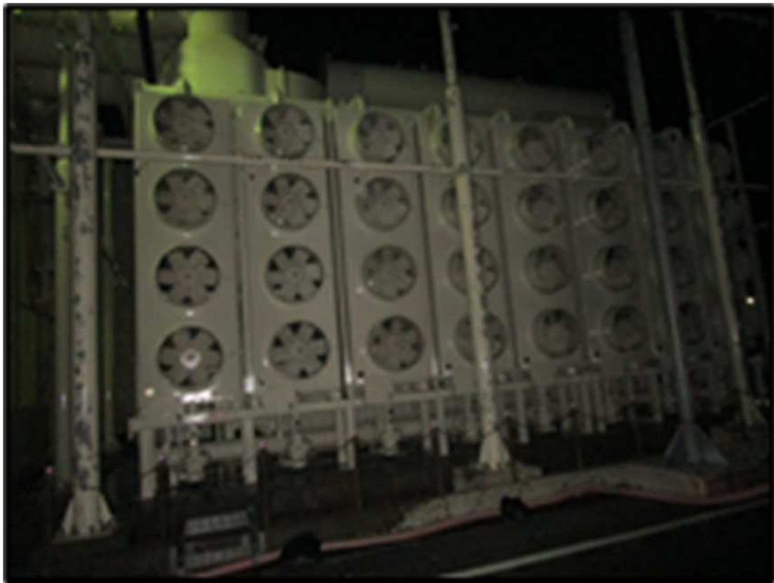
図 2. 2号機主変圧器 漏油状況
