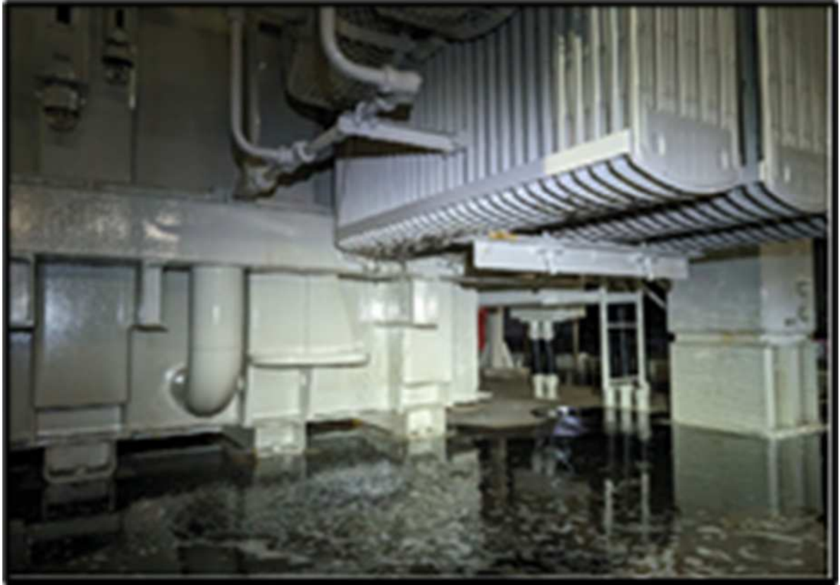
图 2. 1号機 起動変圧器 漏油状況
