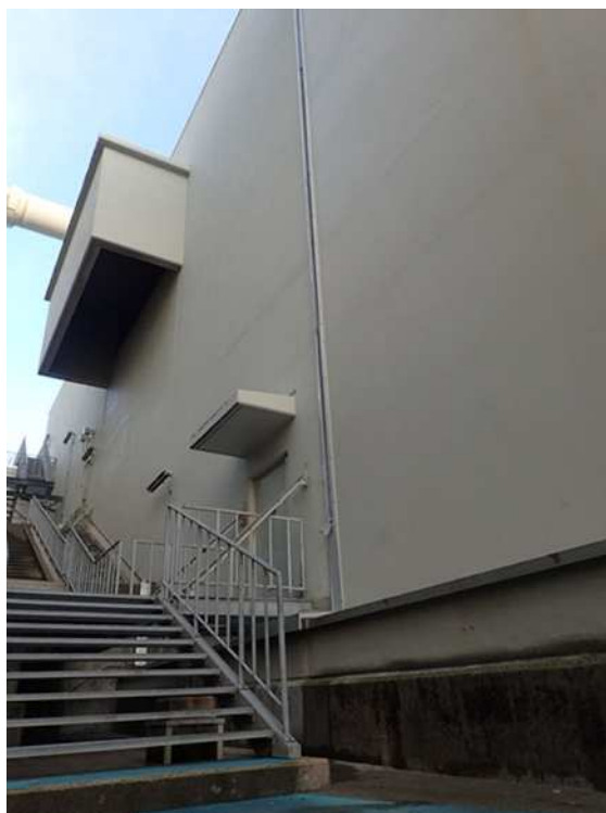
図2. エキスパンションジョイントカバーの脱落状況（2）
