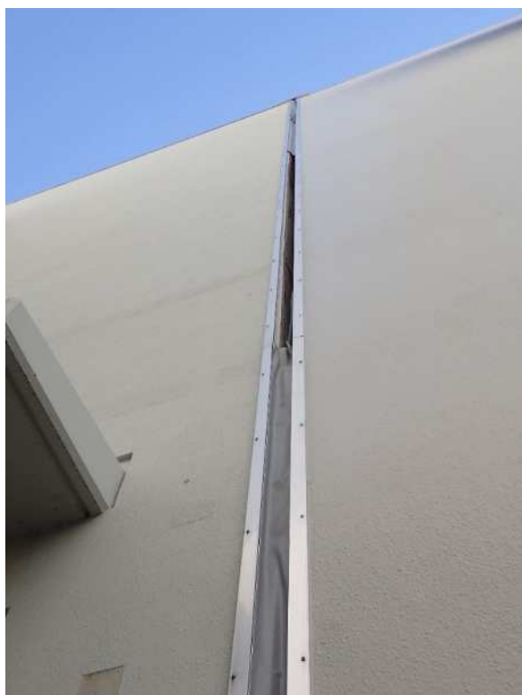
図1. エキスパンションジョイントカバーの脱落状況（1）
