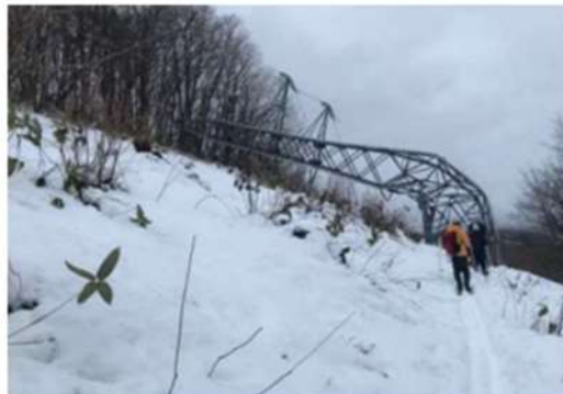
大雪による鉄塔倒壊事例 ※3
