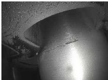
(A-SG第3管支持板のきずの状況)
