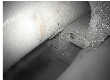
(A-SG第6管支持板のきずの状況)
