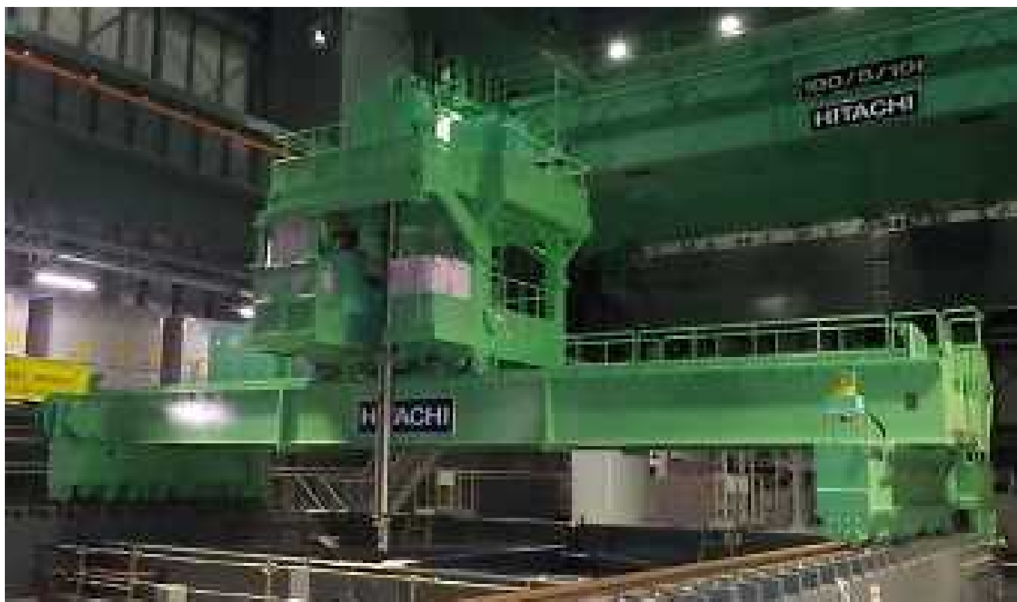
有効活用する4号機燃料取扱機
