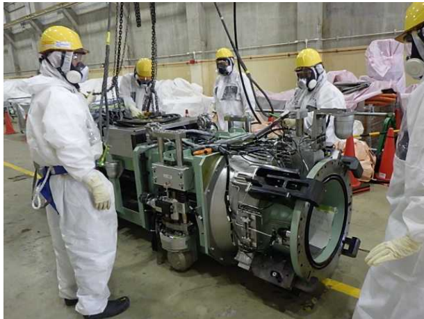
堆積物除去装置 (低圧水) 外観
