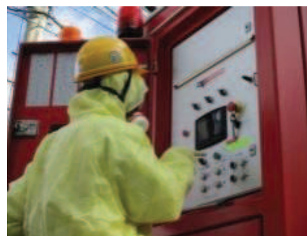
大容量送水ポンプ（タイプⅠ）の起動
