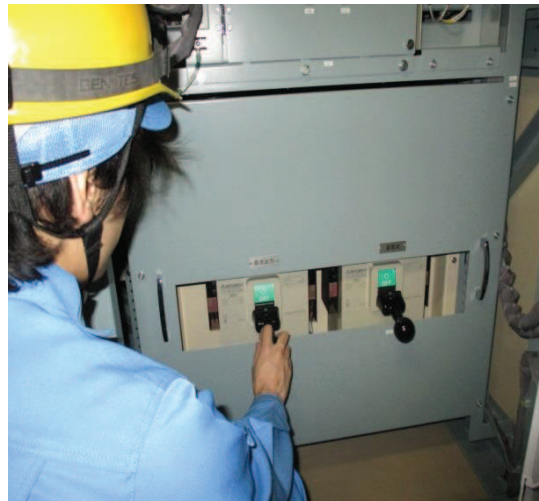
125V 代替蓄電池の切操作
