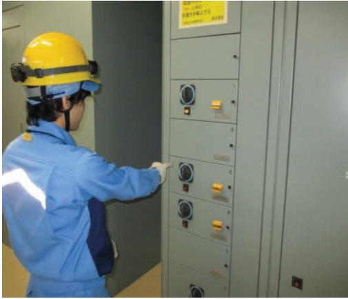
MCC 負荷の切離し操作
