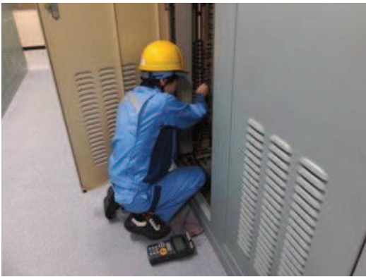
可搬型計測器接続
