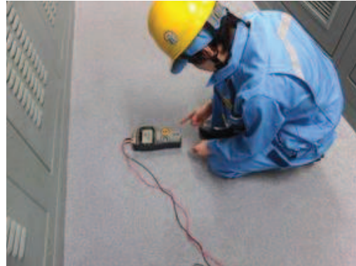
電池容量確認
