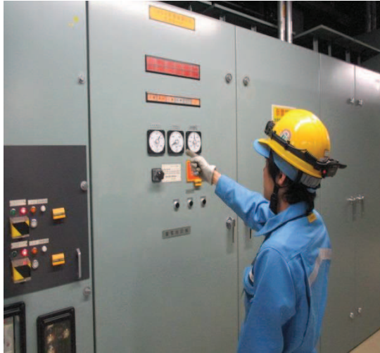
125V 代替充電器の受電状態確認
