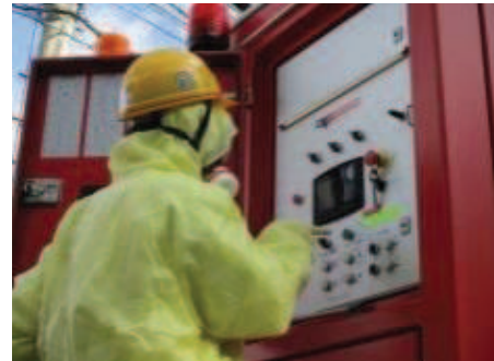
大容量送水ポンプ（タイプ I）の起動
