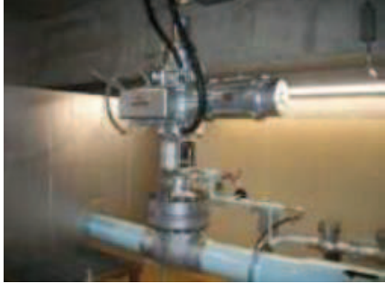
HPCS 注入隔離弁
