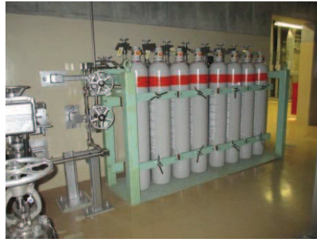
高圧窒素ガスポンベ
