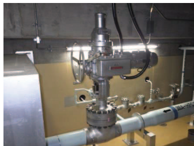
HPCS 注入隔離弁
