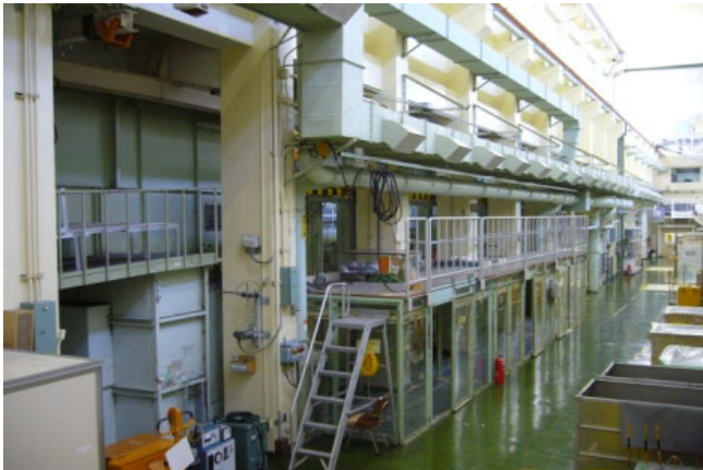
鉛セル付帯設備
