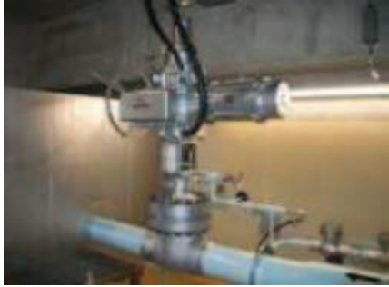
HPCS 注入隔離弁
