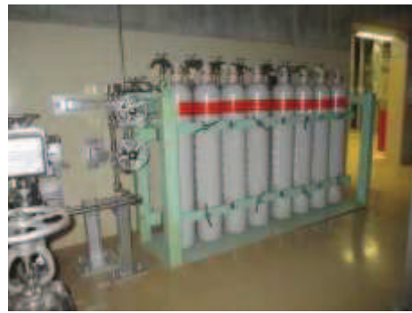
高圧窒素ガスボンベ
