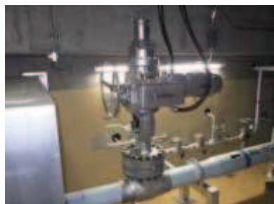
HPCS 注入隔離弁
