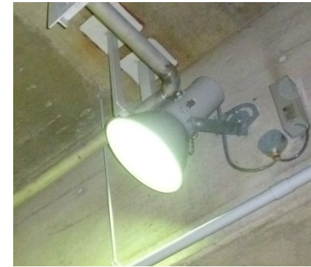
照明の設置状況
