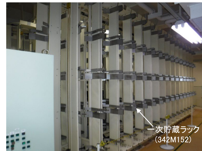
写真① 一時貯蔵ラック(342M152)
