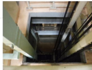
床 (カートン搬出リフトの開口部)
