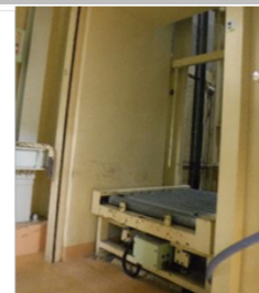
シャッター (乙種防火戸) (保守作業中につき シャッター開状態)
