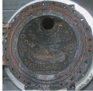
X-6ペネ内部の状況（フランジ面レーザ清掃後）
