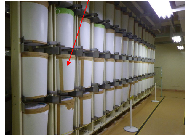
焼却炉運転時の一次貯蔵ラック(342M151/M152)の状況 (運転時は、低放射性固体廃棄物を自動搬送する。)
