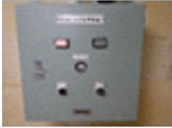
⑤炭酸ガス消火設備(操作盤)
