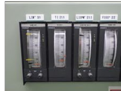
④温度指示計(制御盤)
