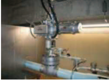
HPCS 注入隔離弁
