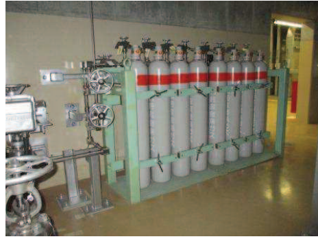
高圧窒素ガスポンベ
