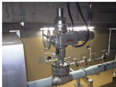
HPCS 注入隔離弁
