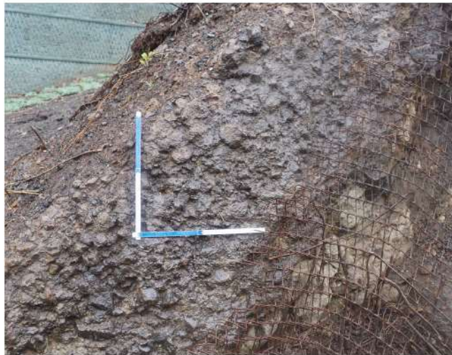
図 2.1.a.c-4 (2) 防潮堤（茶津側）露頭状況 P2 防潮堤擦り付け部近景（P1 拡大） 凝灰角礫岩が分布し，C 級からなる。
