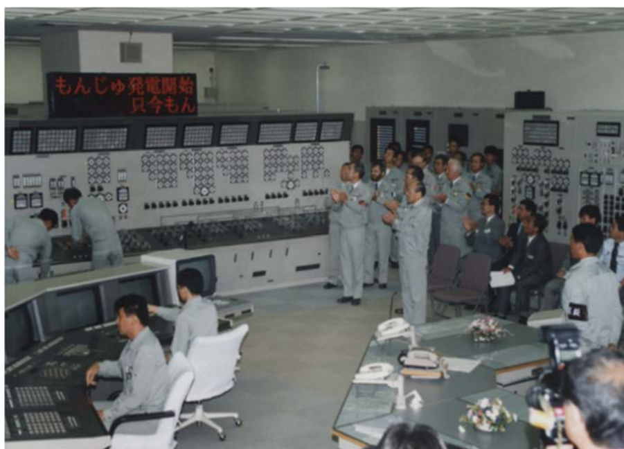
写真3-3 初併入時の中央制御室
