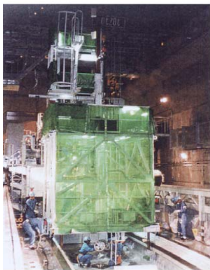
《中性子検出要素取扱装置》 (a) 中性子検出要素の交換
