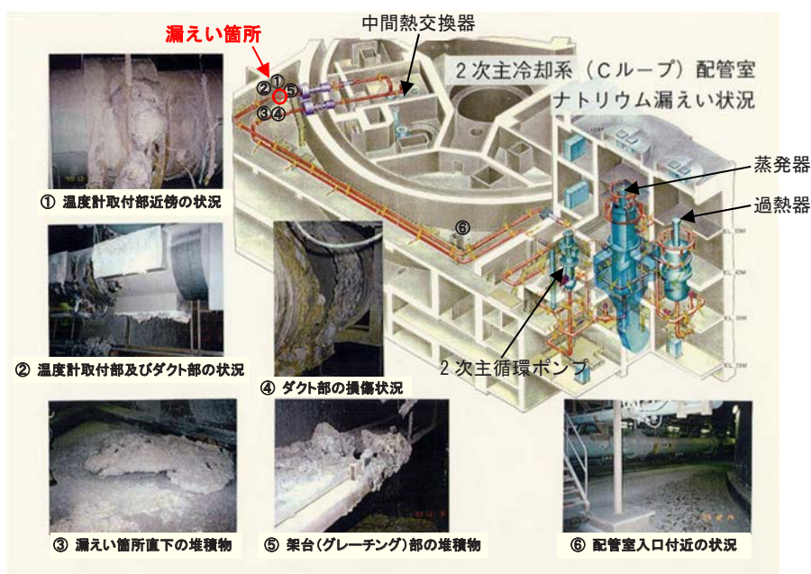
図11-5 2次主冷却系（Cループ）配管室のナトリウム漏えい状況
