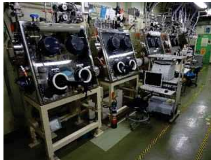
グローブボックス設備
