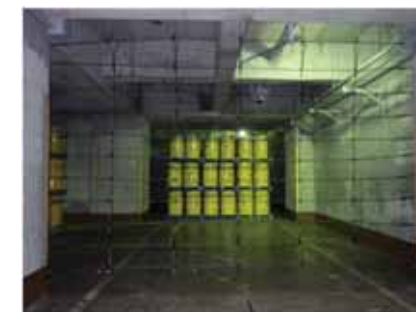
廃棄物容器が流出する可能性のある箇所へのワイヤーネットの設置
