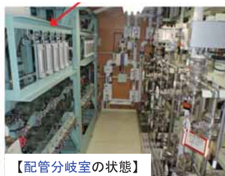
トランスミッタが設置されているラック
