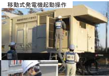
移動式発電機起動操作
