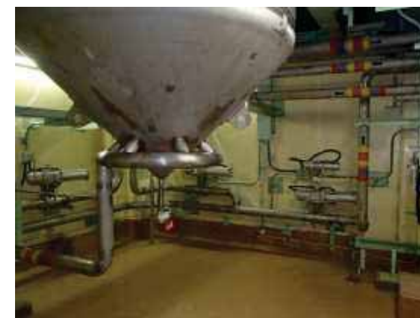
活性炭吸着塔
