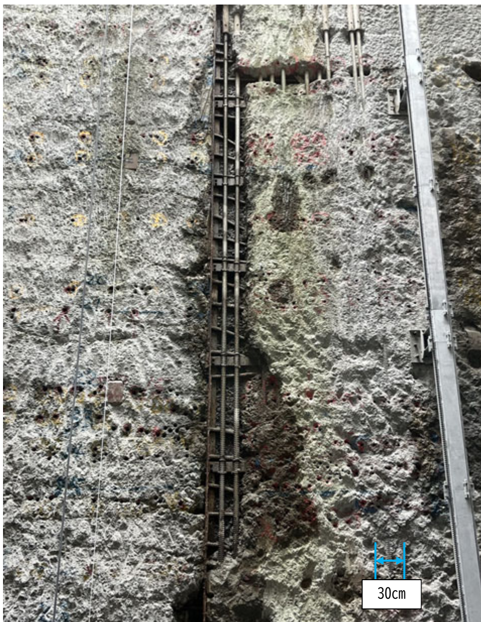
コンクリートの未充填及び鉄筋の変形等の状況写真 (調査のため一部のコンクリートを除去した状態)
