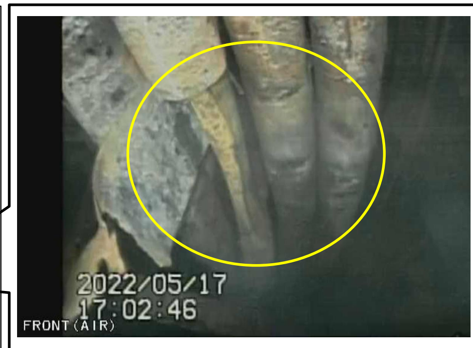
写真2. D/W内配管の状況
