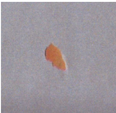
フロー②と判断した塗膜の劣化
