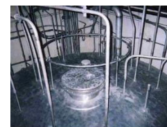
⑤廃液貯槽
