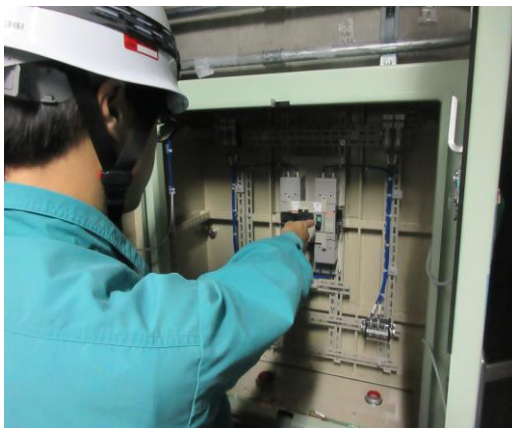
電源切替操作
