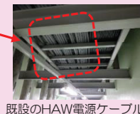
既設のHAW電源ケーブル
