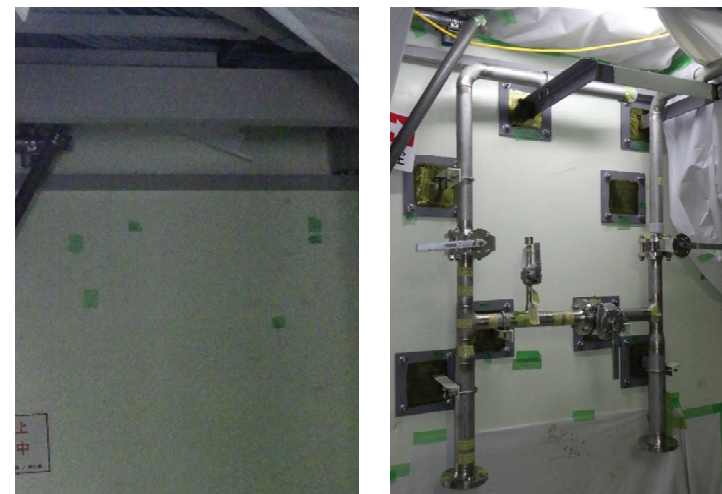
設置前 設置後 冷却水配管への接続口の設置状況 (令和3年12月)
