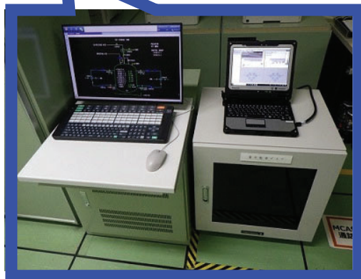
HAWパラメータ監視・屋外監視システム
