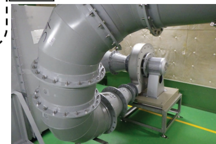
可搬型換気設備の設置時の様子
