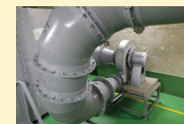
可搬型換気設備
