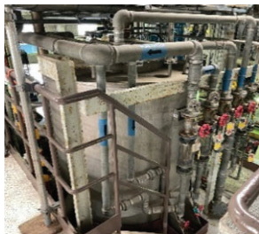
オフガス処理設備 (スクラバ)
