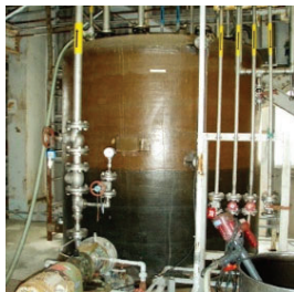
排水処理設備 (廃液槽)
