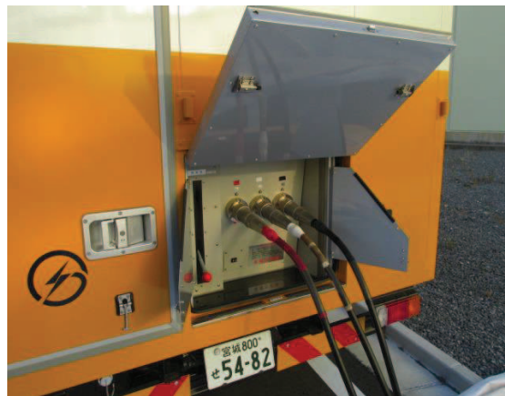
電源車ケーブル接続
