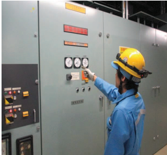
125V 代替充電器の受電状態確認
