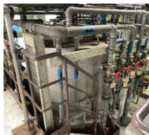
オフガス処理設備 (スクラバ)
