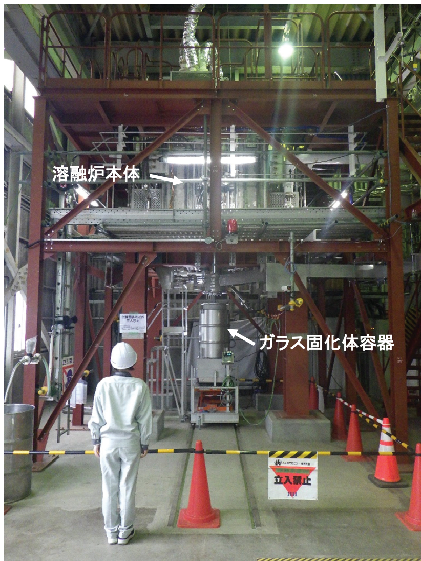
モックアップ試験棟内の3号熔融炉設置状況
