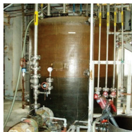
排水処理設備 (廃液槽)
