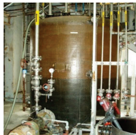
排水処理設備 (廃液槽)
