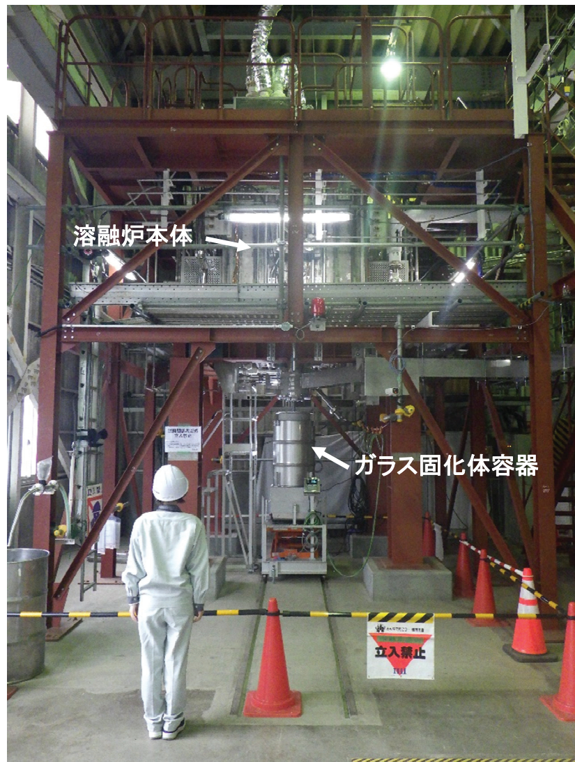
モックアップ試験棟内の3号溶融炉設置状況
