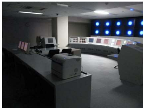
無停電運転保安灯点灯時
