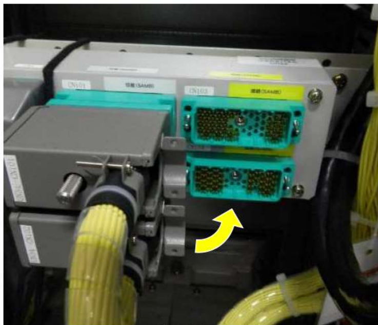
(1次系制御監視盤内 切替器)
