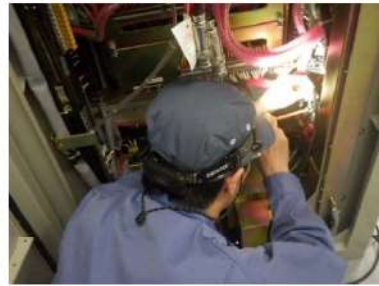
バッテリー繋ぎ込み 原子炉補助建屋 (T. P. 17. 8m)
