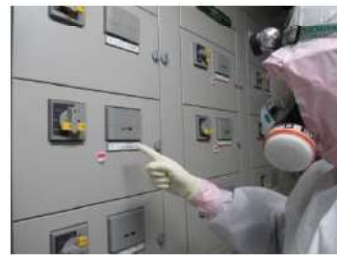
ディーゼル発電機燃料油移送ポンプ 起動操作 (ディーゼル発電機制御盤室) (周辺補機棟T. P. 10. 3m)
