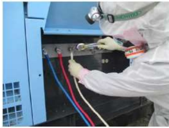
可搬型直流電源用発電機 ケーブル接続(端子) (屋外)
