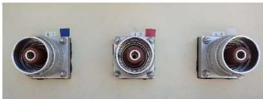
可搬型代替電源車高圧ケーブル接続箇所 (コネクタ) (屋外)
