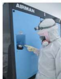
可搬型直流電源用発電機 給油口 （可搬型直流電源用発電機） （屋外）
