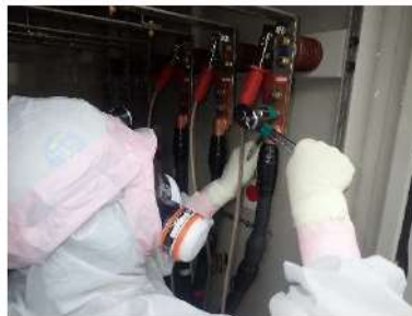
号炉間連絡ケーブル接続（端子） （屋外）
