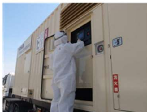
可搬型代替電源車起動 (屋外)
