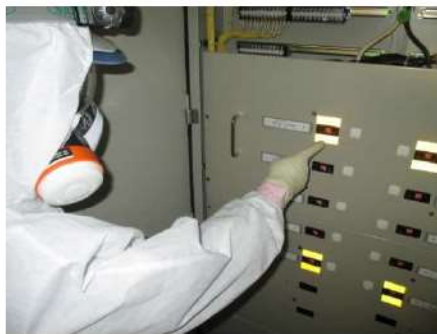
不要直流負荷切離し操作 （安全補機開閉器室） （原子炉補助建屋T.P.10.3m）
