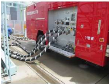
可搬型大型送水ポンプ車の設置 ポンプ車周辺のホース敷設 （屋外）
