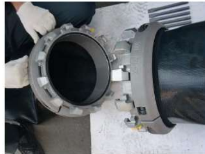
可搬型ホース(300A)接続
