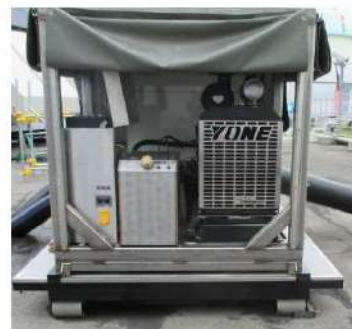
泡混合設備設置 (屋外)
