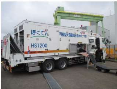
可搬型大容量海水送水ポンプ車の設置 (屋外)
