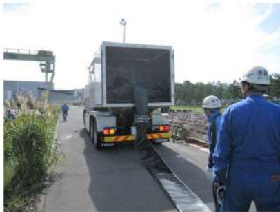
ホース延長・回収車（放水砲用） による可搬型ホース敷設 (屋外)
