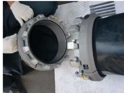
可搬型ホース(300A)接続
