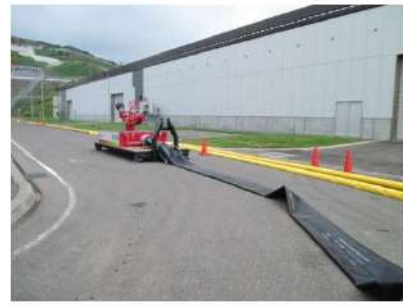
放水砲設置 (屋外)
