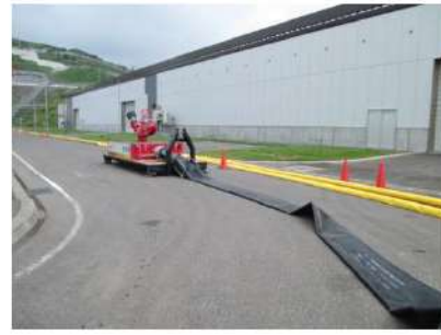
放水砲設置 (屋外)
