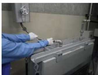
空冷配管との接続
