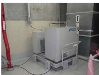
監視カメラ空冷装置
