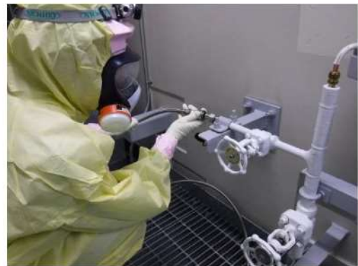
代替空気(窒素)供給用フレキシブル配管接続 (周辺補機棟 T. P. 17. 8m (中間床))
