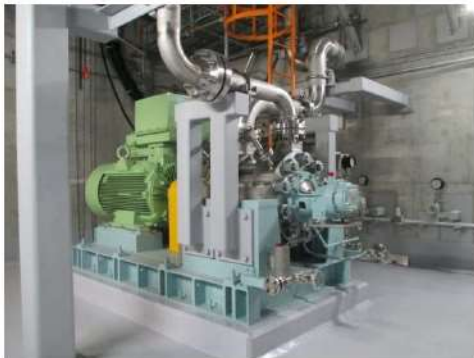
代替格納容器スプレイポンプ (周辺補機棟 T.P. 10.3m)
