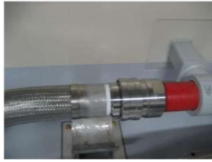
消火水系配管と 格納容器スプレイ系配管との 接続のための可搬型ホース接続後 (運転員(現場) B) (原子炉補助建屋 T. P. 10. 3m)
