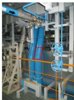
可搬型温度計測装置（格納容器再循環ユニット入口温度／出口温度）設置場所（供給側） (周辺補機棟 T.P. 10.3m（中間床）)
