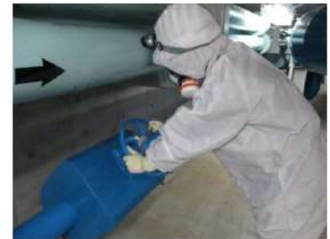
通水操作 (周辺補機棟 T.P. 2. 3m)
