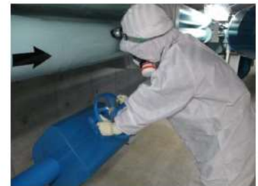
通水操作 (周辺補機棟 T.P. 2.3m)
