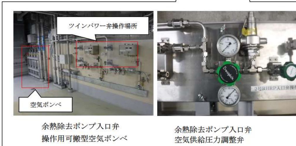
図3 ツインパワー弁操作場所及び余熱除去ポンプ入口弁操作用可搬型空気ポンベ
