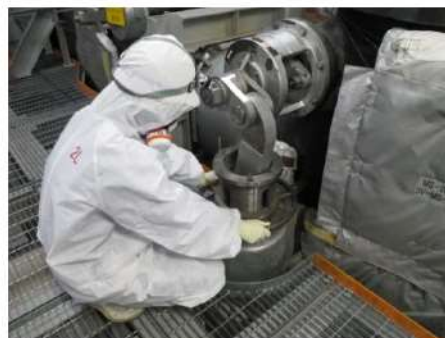
主蒸気隔離弁増締め操作 (周辺補機棟 T.P. 33. 1m)
