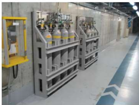
主蒸気逃がし弁操作可搬型空気ポンベ (周辺補機棟 T. P. 10. 3m)
