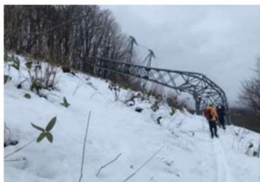
大雪による鉄塔倒壊事例 ※3
