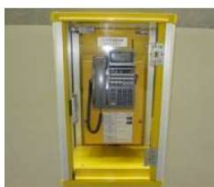
運転指令設備（警報装置を含む）
