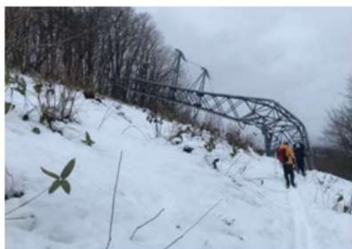
大雪による鉄塔倒壊事例 ※3
