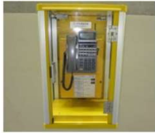
運転指令設備（警報装置を含む）
