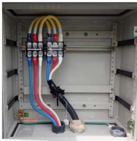
ボルト・ネジ接続 (代替直流電源)
