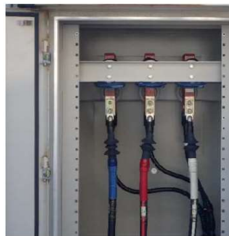
ボルト・ネジ接続 (代替交流電源)
