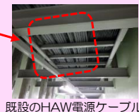
既設のHAW電源ケーブル
