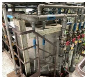
オフガス処理設備 (スクラバ)
