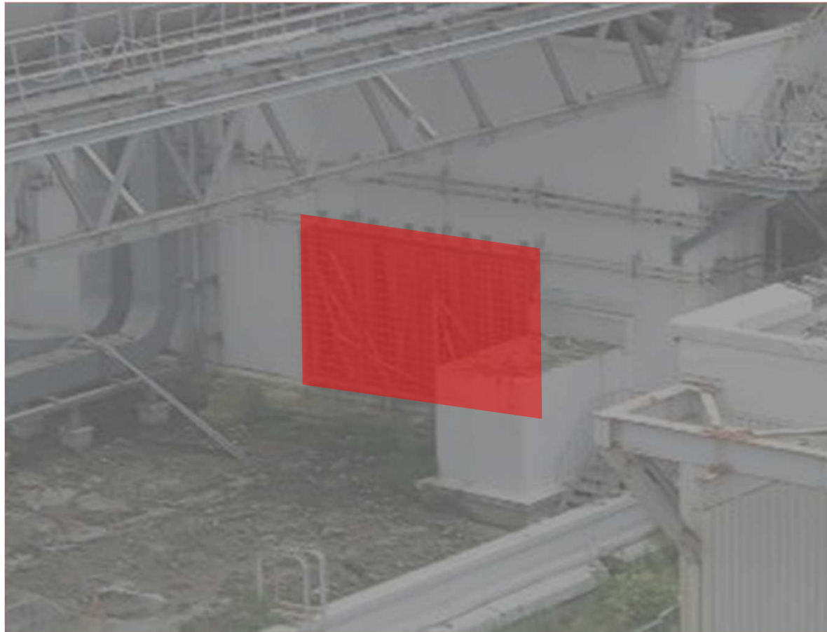
参考写真：雨水侵入箇所
