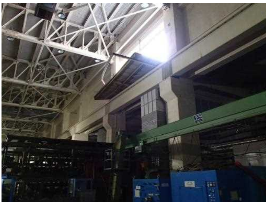
写真①：BOP損壊部分（塞ぎ前、屋内）
