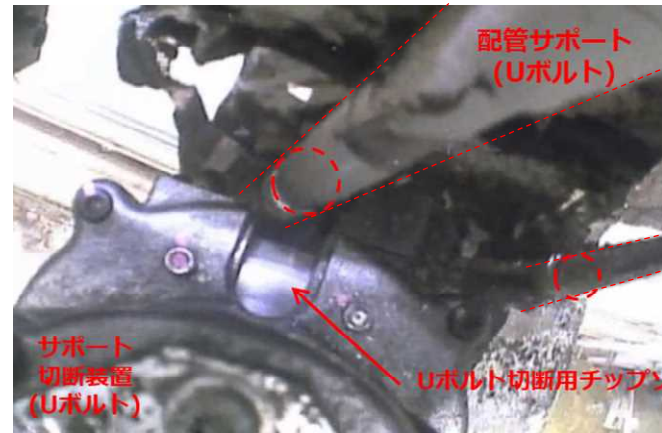
配管サポート切断
