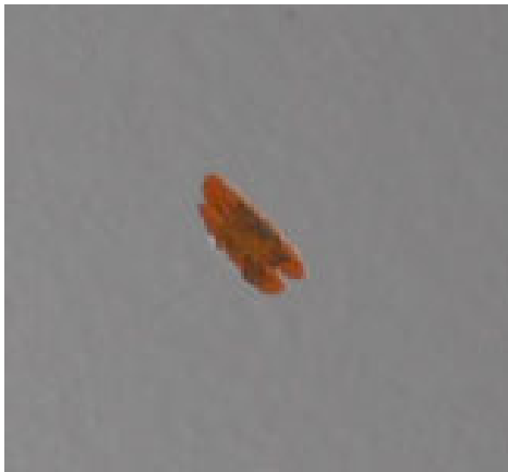
点検フロー③と判断した塗膜の劣化の例 (4号炉 円筒部外面の写真)
