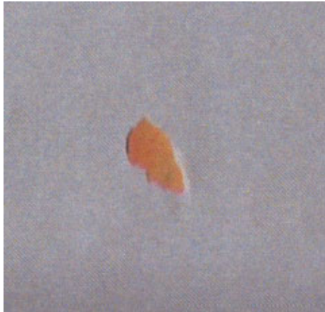
点検フロー②と判断した塗膜の劣化の例 (3号炉 円筒部外面の写真)
