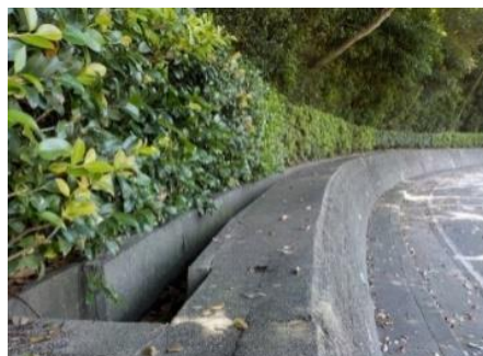
浜岡原子力館周りの側溝
