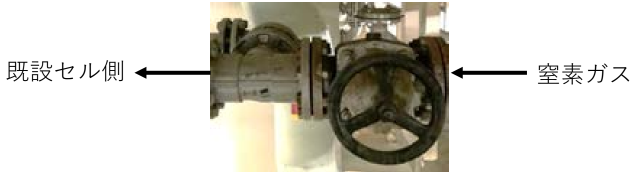
窒素ガス供給設備
