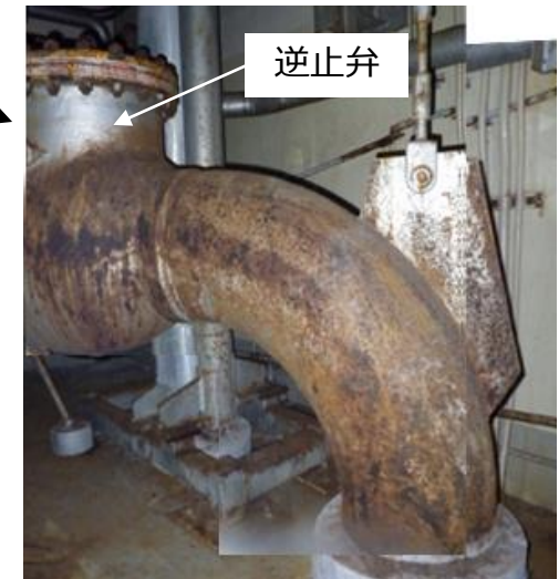
既設CUW配管
