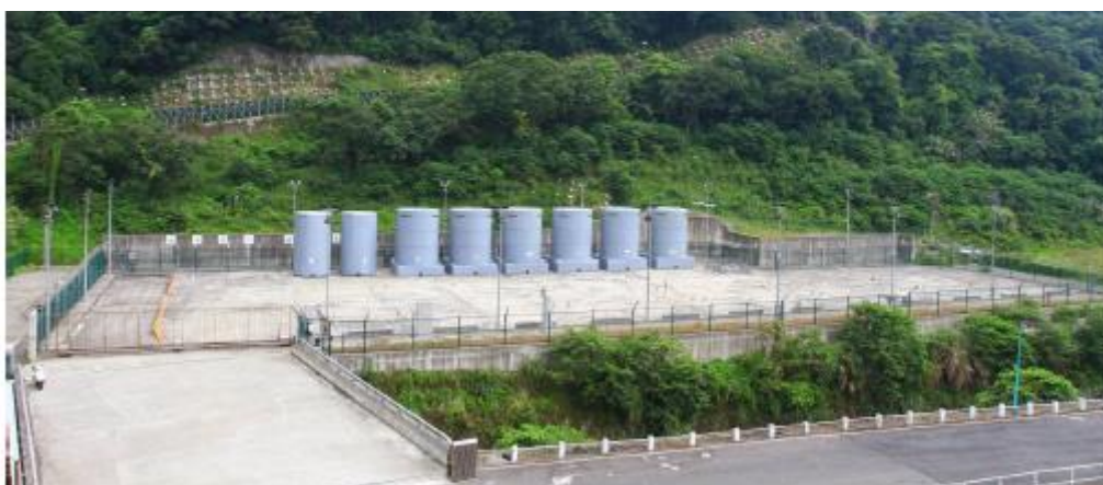
図 2.1-39 第一（金山）原子力発電所の乾式貯蔵施設[TWN1]
