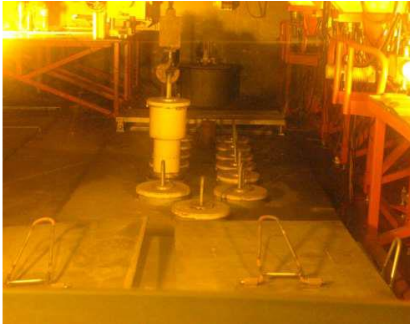
図 2.1-24 照射後試験施設（LEPI）の燃料残材貯蔵ピット[ROU1]
