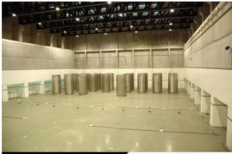
図 2.1-33 トリロ発電所の乾式貯蔵施設（金属キャスク） [ESP5]
