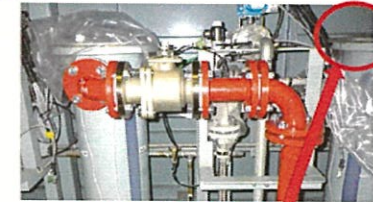
UO2F2貯槽C(2022.8.23) 蓋開放状態（ビニールで養生）
