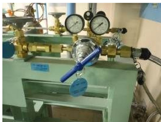
3号機余熱除去ポンプ入口弁 窒素供給圧力調整弁
