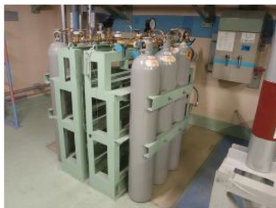
3号機余熱除去ポンプ入口弁 駆動用窒素ボンベ
